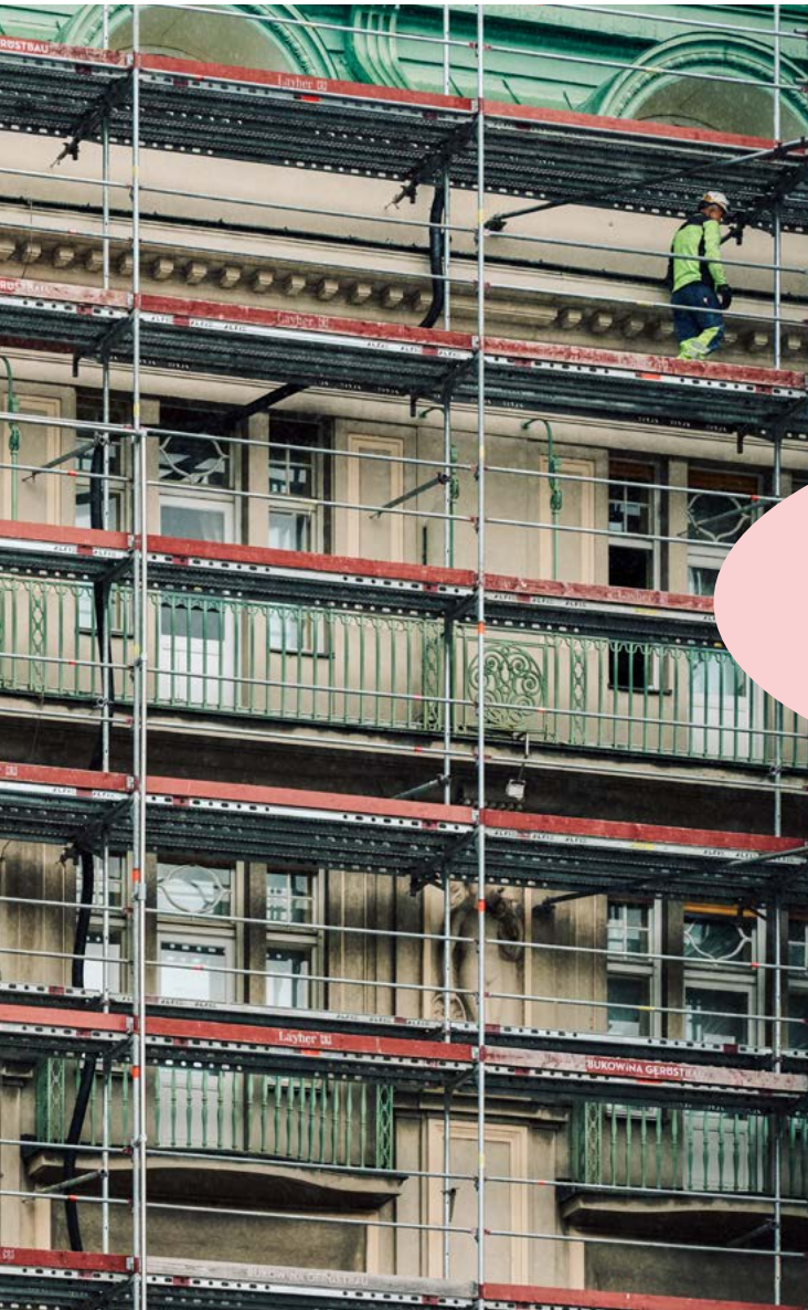
Die Baustelle, auf der Branko D. an der Renovierung eines großen Hotels arbeitete.
